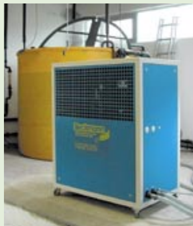
Das neue Kühlaggregat amortisiert sich bereits nach eineinhalb Jahren.
