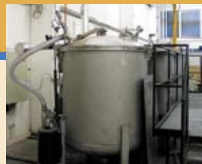
Neue Imprägnieranlage mit Harzrückgewinnung.
